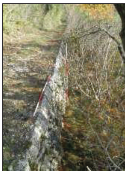
Slika 3.11.8. Podzid ceste s donje strane
