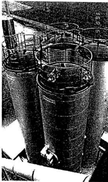
Slika 4. Spremnici za bitumen proizvođača Benninghoven
