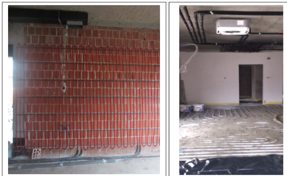
Ventilokonvektori, zidno i podno grijanje u novoj zgradi jaslica dječjeg vrtića Pjerina Verbanac u Labinu
