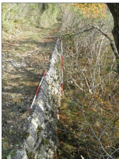
Slika 3.11.8. Podzid ceste s donje strane
