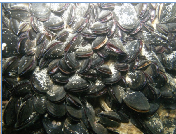
Slika 102. Gusto naselje dagnji na betonskoj rivi mosta, dubina oko pola metra
