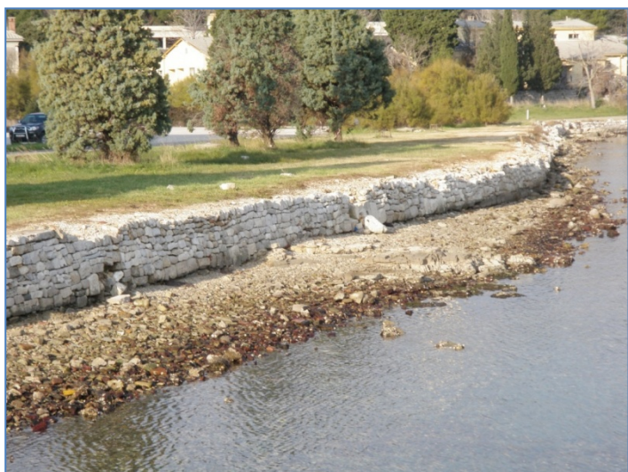
Slika 86. Područje zahvata u „zimsko“ doba, za vrijeme velike oseke. Izgrađena obala i nasuto kamenje ispred nje. Kamenje pod utjecajem mora je obraslo raznim organizmima
