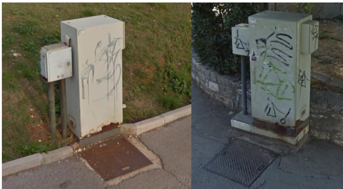
Slika 99. Korodirala kućišta semaforских uređaja
