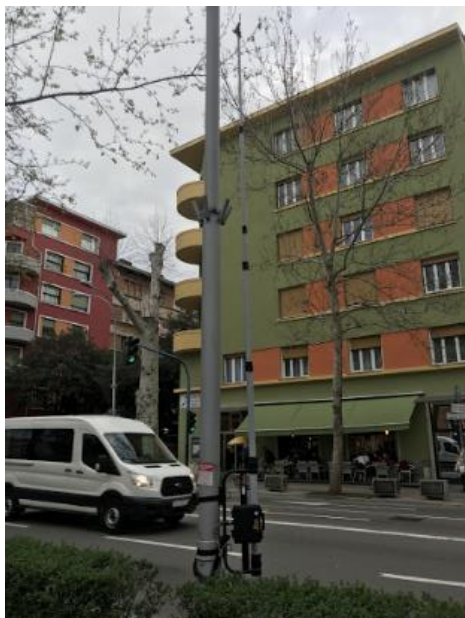
Slika 14. Primjer instalirane kamere za brojanje prometa
